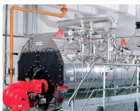
Chaudière à vapeur
