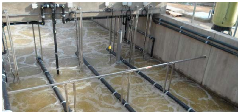
Réacteur biologique / station d'épuration, type SBR
